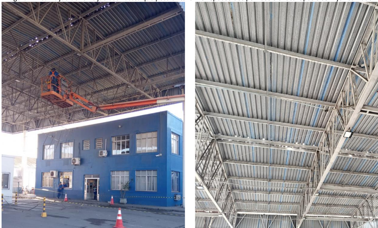
Figura 4: Realização de remoção das hastes que possibilitavam o repouso dos pombos e o local após o serviço realizado.
