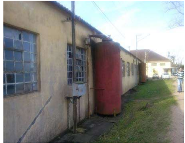
Figura 38 - Tanques de ar comprimido Fonte: Autores (2013)
