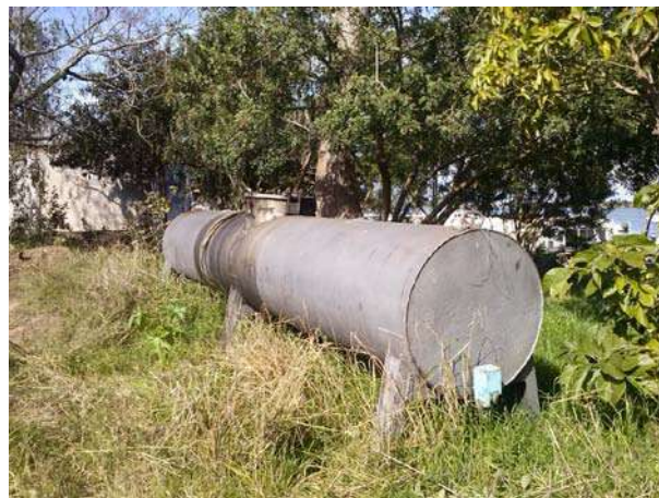
Figura 36 - Tanque de armazenamento de óleo usado Fonte: Autores (2013)
