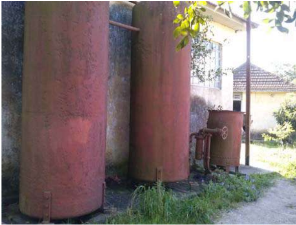
Figura 37 - Tanques de ar comprimido Fonte: Autores (2013)
