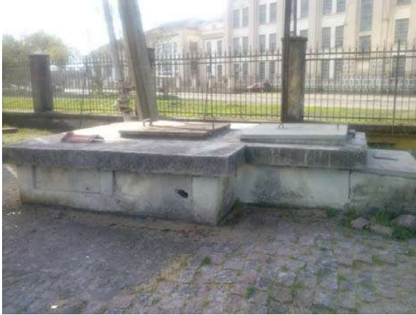
Figura 67 - Caixa d'água Fonte: Autores (2013)
