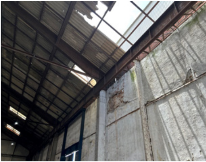
Estado precário dos Armazéns A5, A7, A7/8
