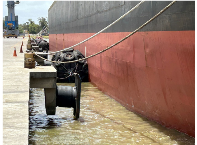
Boias tipo Yokohama devido ao assoreamento no costado cais
