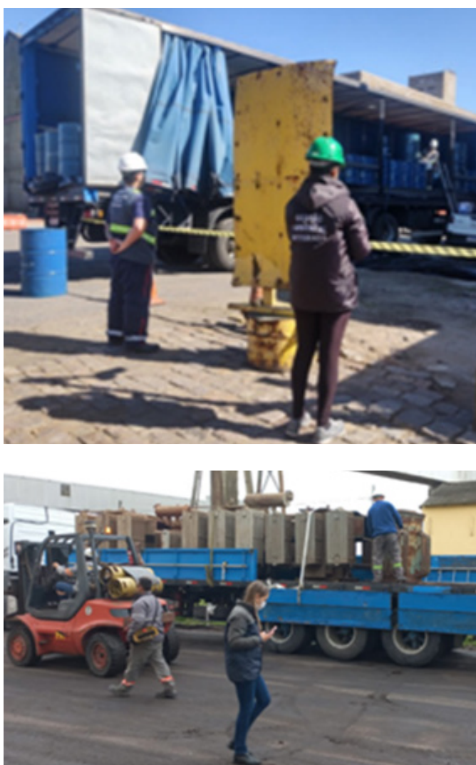
Figura 30: Processo de remoção dos transformadores contaminados com PCBs, em Rio Grande e Pelotas.
