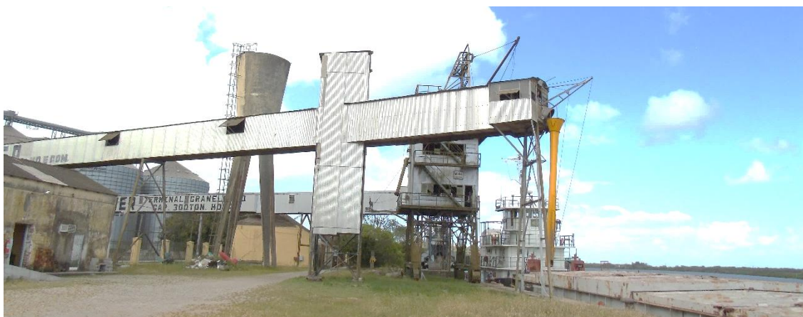
Figura 102 – Correias transportadoras e carregador de navios no Porto de Pelotas Fonte: Imagem obtida em visita técnica (2018). Elaboração: LabTrans/UFSC (2019)
